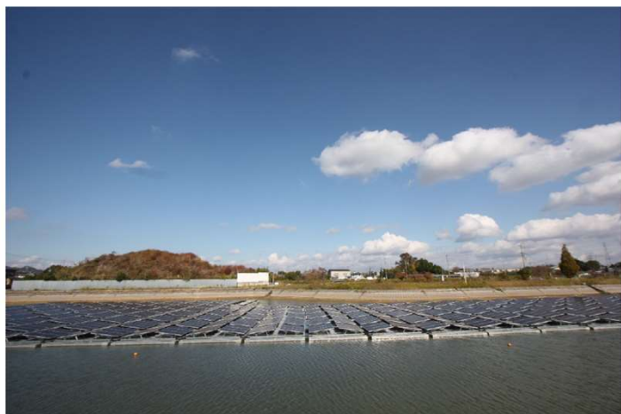
兵庫県・ハリマ化成・水足狩ヶ池太陽光発電所・920kW
