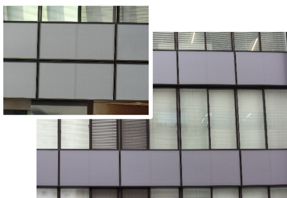
大成建設横浜支店太陽光発電設備 「カラーソリッドタイプ」
