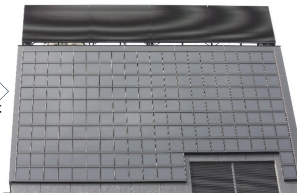
大成建設横浜支店太陽光発電設備「ソリッドタイプ」
