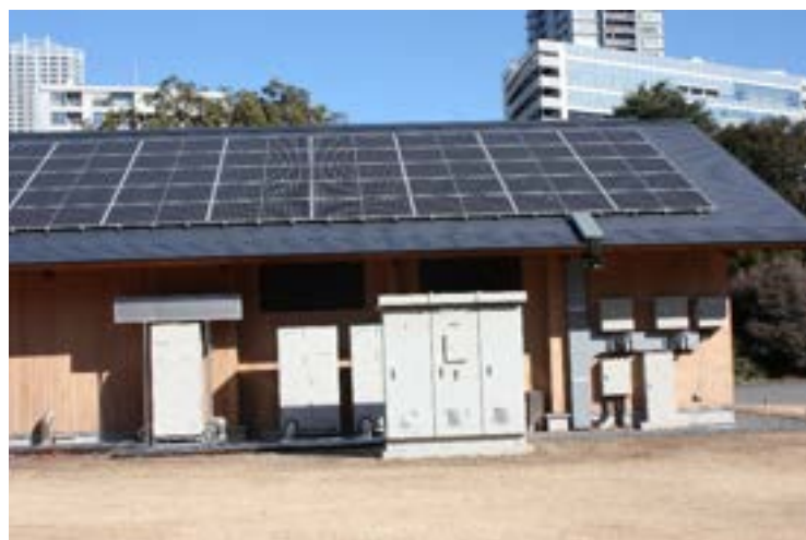
新宿御苑太陽光発電設備 (その2)
